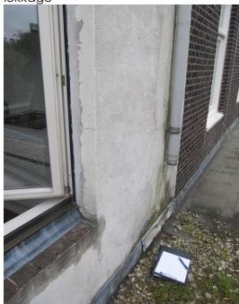
Foto 4: Hemelwaterafvoer, deel ontbreekt
