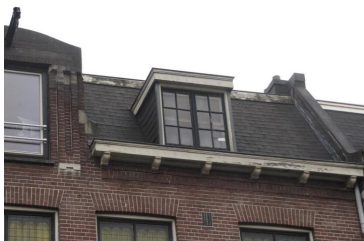
Foto 3: Gooten dakrandbetimmering vertoont houtrot
