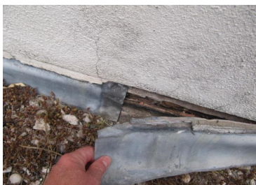
Foto 2: Voetlood ligt los, opstand is te laag met kans op lekkage
