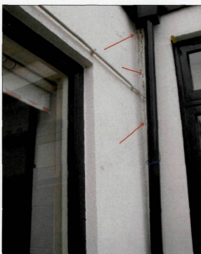
Foto 10: Scheurvorming aansluiting achtergevel-uitbouw nr. 42.
