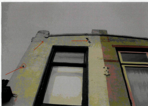
Foto 6: Scheuren en loszittend stucwerk vanaf de dakrand tot bovenkant raamkozijn in de voorgevel van nr. 42. Links op de foto op ongeveer de halve hoogte van de opbouw is te zien dat het muuranker niet meer volledig aanwezig is.
