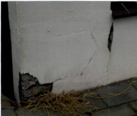
Foto 14: Scheurvorming in de rechterhoek van de straatgevel van nr. 42.
