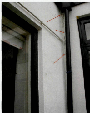
Foto 10: Scheurvorming aansluiting achtergevel-uitbouw nr. 42.
