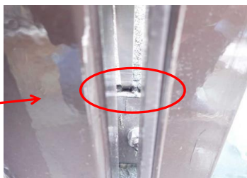
Afb 19. Voorbeeld van één van de openingen in de dakbedekking rondom de montageplaat afscheiding.
