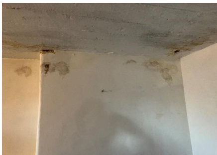
Vochtplekken op het schoorsteenkanaal/ plafond
