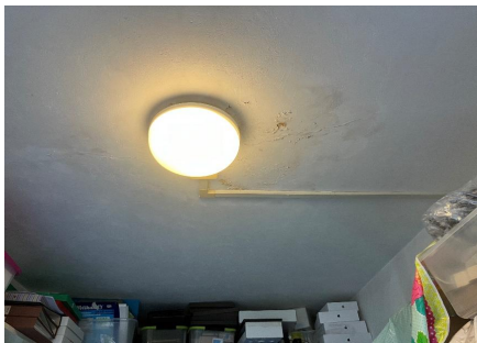
Vochtplekken/ onthecht witwerk rond de plafonddamp
