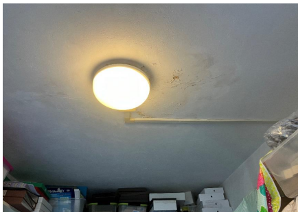
Vochtplekken/ onthecht witwerk rond de plafonddamp
