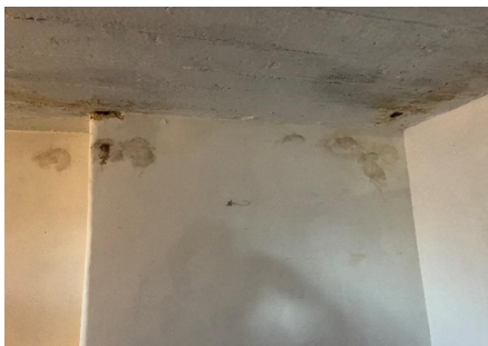
Vochtplekken op het schoorsteenkanaal/ plafond
