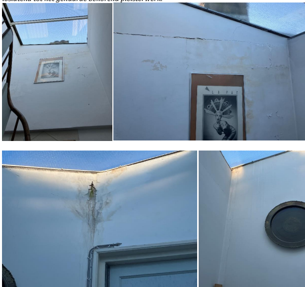
Lekkageplekken en scheurvorming in het trappenhuis
